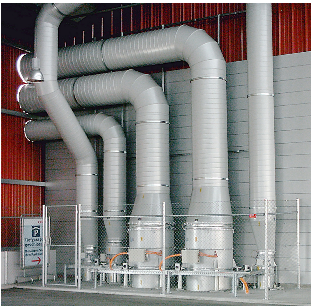
COOP Silbern, Dietikon: Aussenaufstellung Entrauchungsventilatoren
