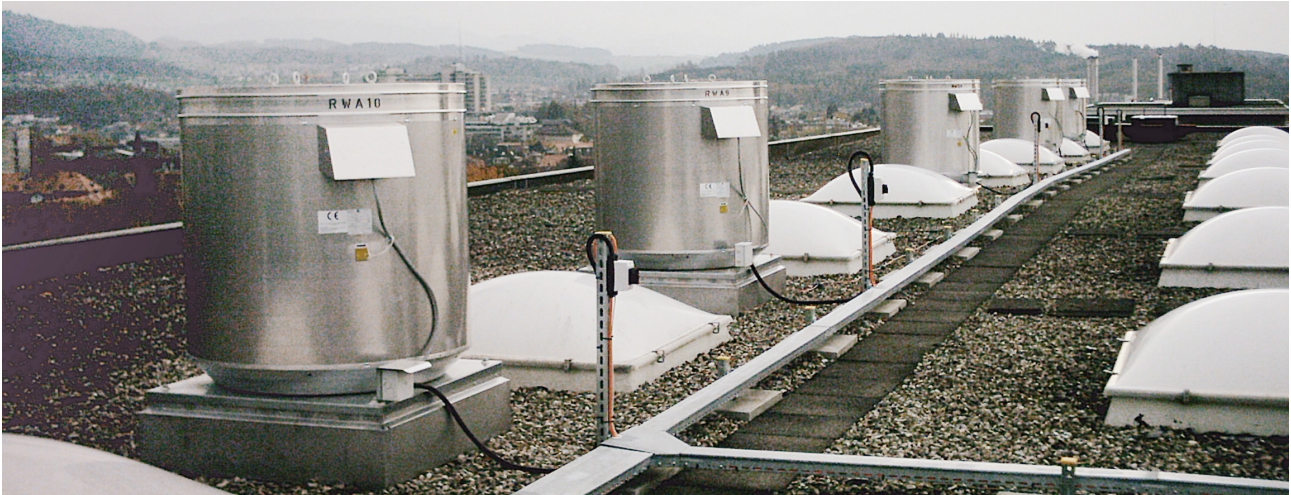
Gymnasium Neufeld, Bern: Entrauchungsventilatoren BVD F400, 10 Stück
