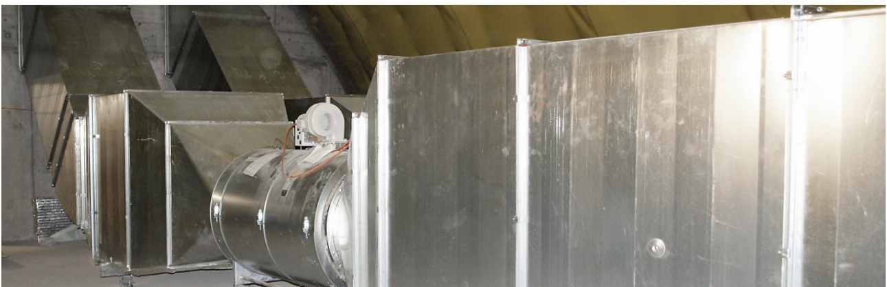
IFA-Tunnel, Lungern: Abluft Feuerwehr Übungstunnel, Entrauchungsventilatoren F600 mit Fremdbelüftung
