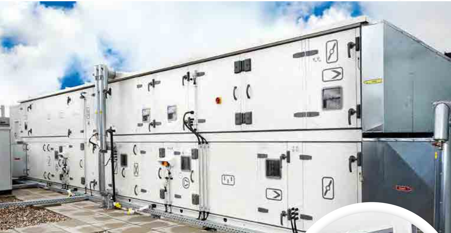
TROX X-CUBE Zentralgerät auf dem Dach des Gerbers.
